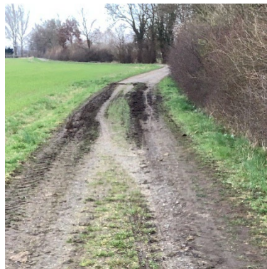
Abb. 48: Spazierweg in schlechtem Zustand
