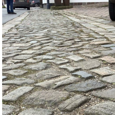
Abb.: unebener Gehweg Hoetmar
