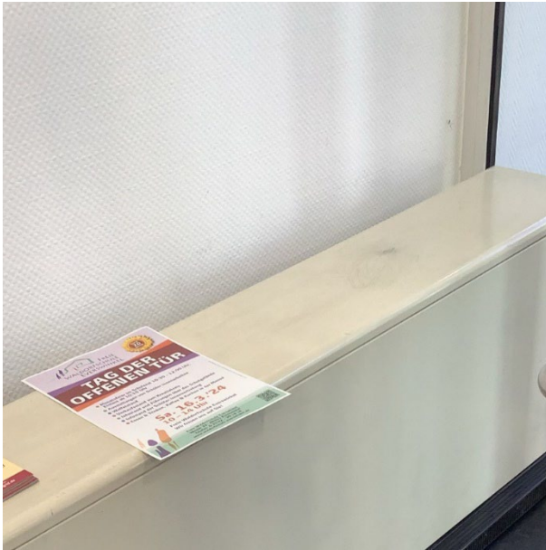
Abb. 63: Die Heizung in der Bank wird als Ablage für Flyer genutzt
